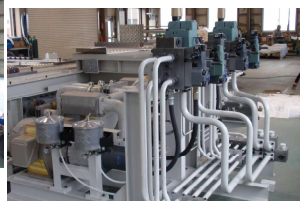
射出成型機油圧配管
