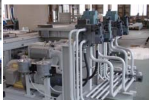
射出成型機油圧配管
