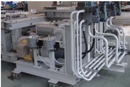
射出成型機油圧配管
